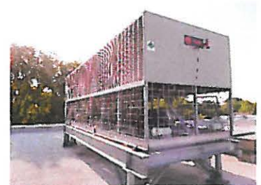
Existing 124 Ton Trane Chiller
